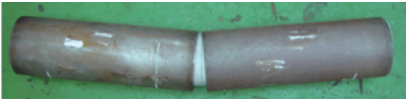
图 10 含聚脲内衬层的钢管在接口处开裂后的情况 [42]
